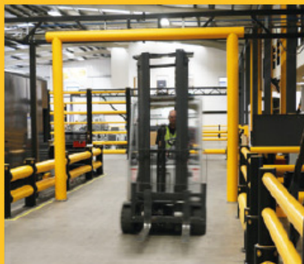
Hoogtebegrenzing beschermt de elektriciteitskabels in een productieomgeving.
